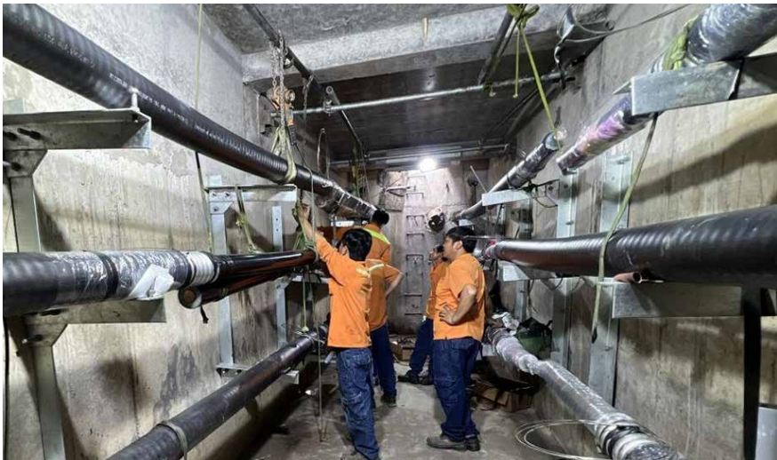
Hình 2. Hệ thống cáp điện trong công trình ngầm 220 kV Tao Đàn - Tân Cảng, Thành phố Hồ Chí Minh (nguồn: Tổng công ty Truyền tải điện Quốc gia - EVNNPT, 2023) Figure 2. Power cable system inside the 220 kV Tao Dan - Tan Cang underground tunnel, Ho Chi Minh City (source: National Power Transmission Corporation - EVNNPT, 2023)
