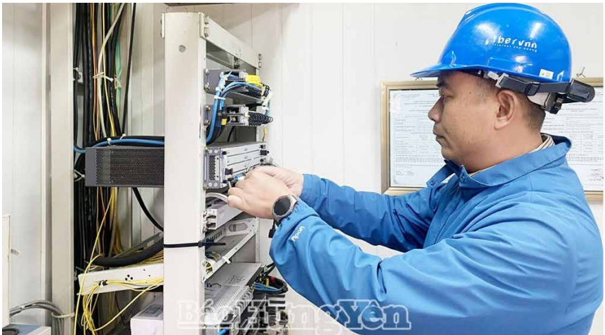
Hình 3. Trạm viễn thông Đông Chiểu, xã Liên Phương, thành phố Hưng Yên, được VNPT và MobiFone chia sẻ, dùng chung [15] Figure 3. Dong Chieu telecommunications station, Lien Phuong commune, Hung Yen city, shared between VNPT and MobiFone [15]
