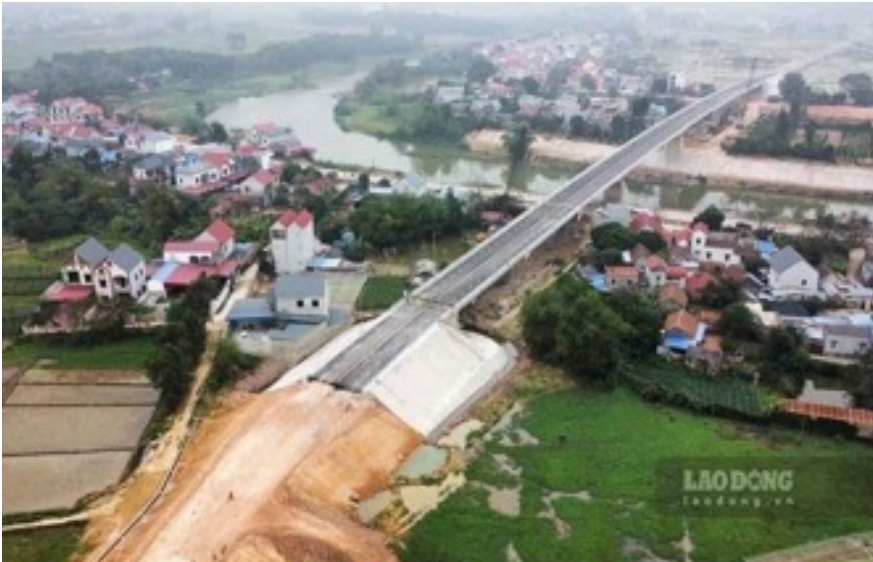
Hình 5 – Thí dụ về sự thiếu đồng bộ giữa thi công cầu và đường dẫn
